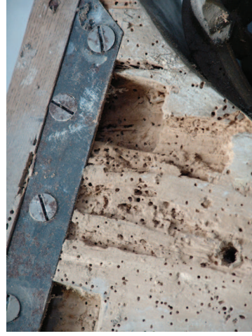
Achterzijde sokkel: schade (aantasting)
